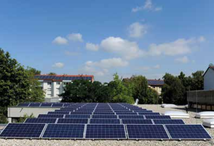
Photovoltaik-Kundenanlage auf der Quartiersmensa plus St. Hedwig
